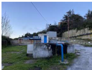
Depuratore di Santo Stefano di Camastra
